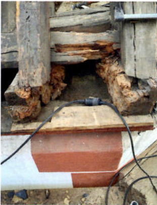
Massive Schäden an Deckenbalken und Sparren
